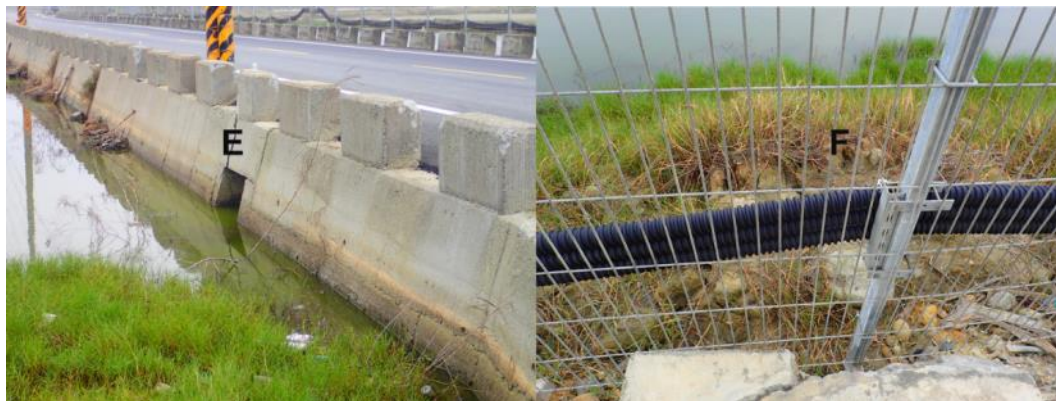
圖 4-3、嘉 30 公路下西側的箱涵，(E)北邊的箱涵、(F)南邊堵塞
